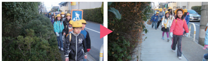
幅が狭く危なかった富野小学校正門前の歩道が拡幅されました。(平成23年12月)
